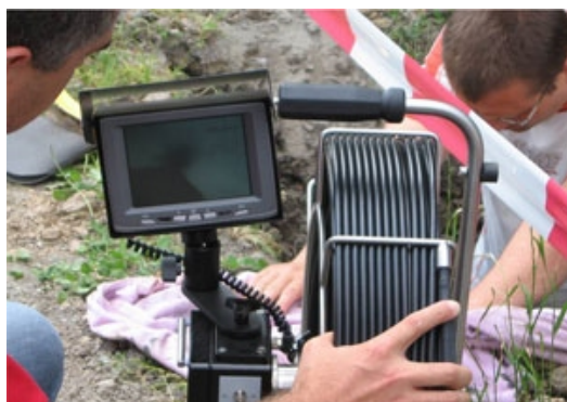
zařízení pro monitorování
